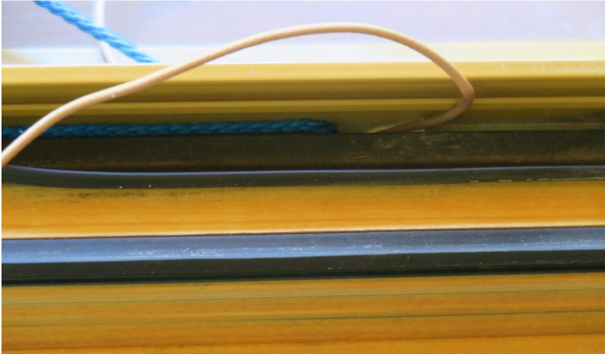
Entwässerungsschlitz im Fensterrahmen
